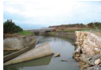
河口を遡る津波は護岸のコンクリも剥がしてしまいました。
